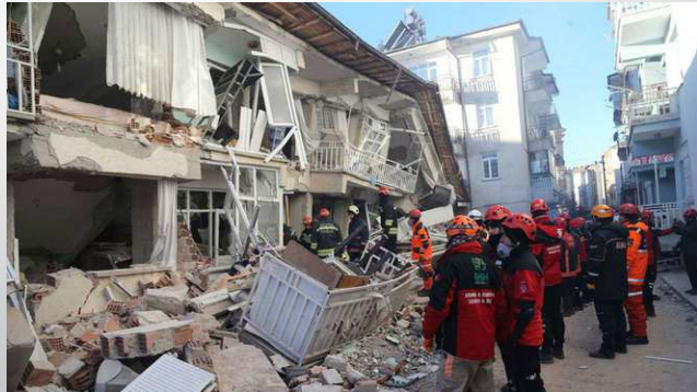
Daños en viviendas debido al Terremoto de Turquía, profundidad de 6.7km (Enero, 2020)
