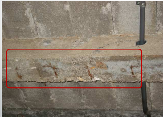
Refuerzo transversal (aros) expuesto a la intemperie
