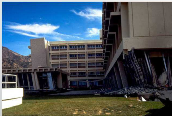
Evidente pérdida de verticalidad del Hospital Olive View (California) debido al Terremoto de San Fernando, 1972.
