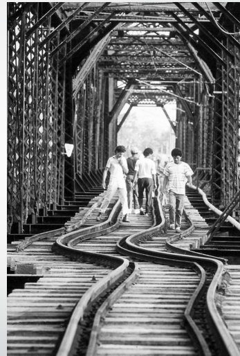
Daño en puente metálico y en la vía férrea. Terremoto de Limón, 22 de abril, 1991.
